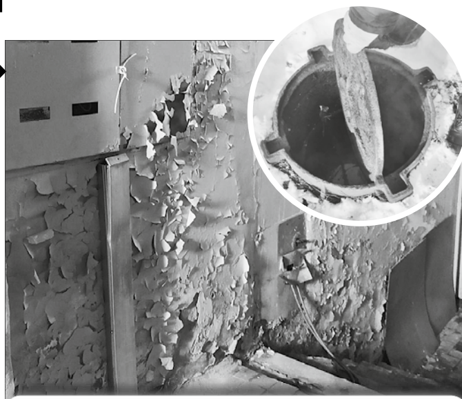
Подвалы Розы Люксембург, 12 регулярно топят стоками, в подъездах так сыро, что со стен слезает краска и штукатурка.
